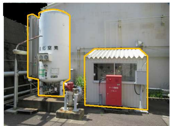
コールドエバポレーター
